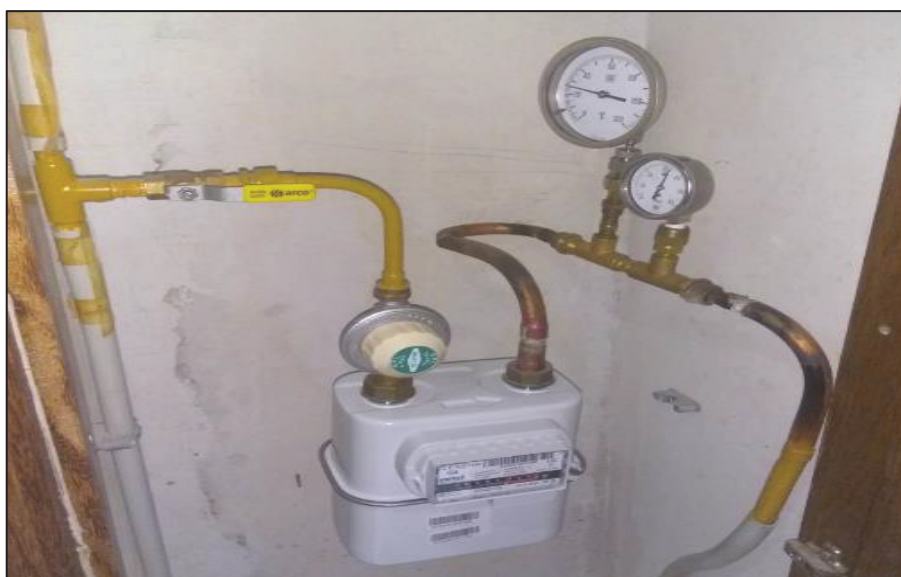
Figura 8. Instalação do termómetro e manómetro à saída de uma instalação de gás.
