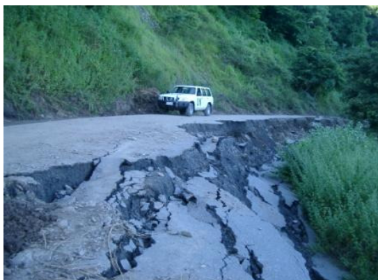
Figura 15: Estrada com forte degradação do pavimento numa zona rural (Soares D., 2009).
