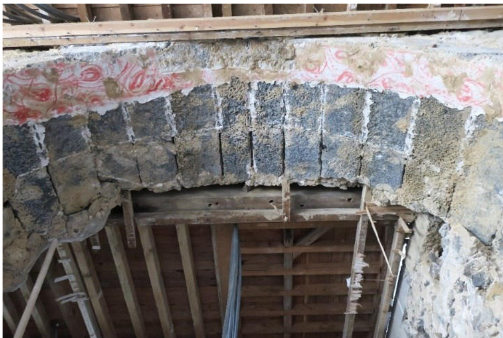
Figura 26 – Vestígios de frescos que existem no arco do coro baixo que deveria corresponder a um antigo altar
