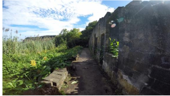
Fig. 3.94. Casa de repouso em estado de abandono
