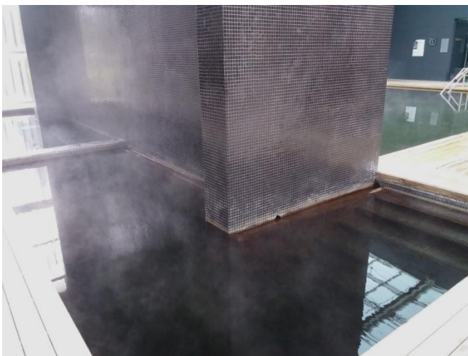
Fig. 3.59. Tanque de água termal
