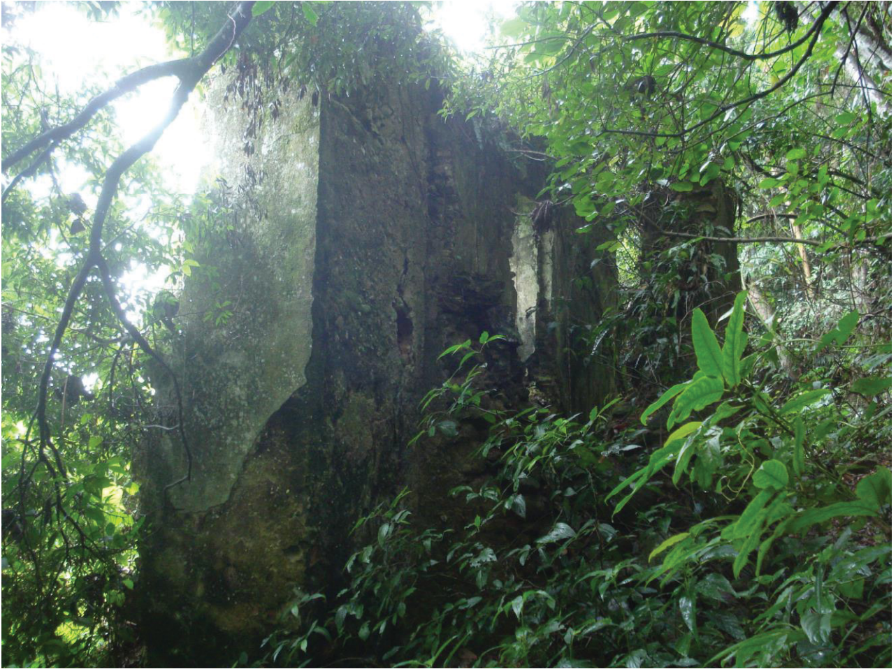
18 - Paiol da Pólvora encontra-se até hoje em estado de ruínas. Não tem previsão de restaurá-lo. Fonte: Acervo pessoal de Jefé.
