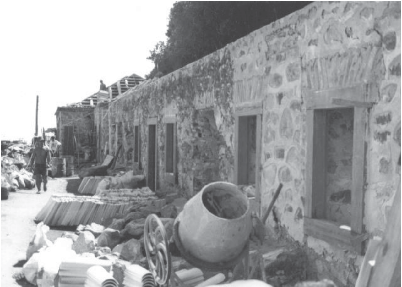
9 - Fortaleza de Ratores durante as obras de restauração ocorridas em 1990. Fonte: Acervo do DAEX/UFSC - Date: 1990. Disponível em: http://fortalezas.org/index.php?ct=fortaleza&id_fortaleza=2
