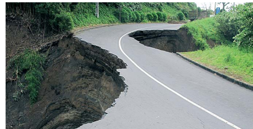
Fig. 3 - Impacte de um evento de instabilidade geomorfológica em vias de comunicação
