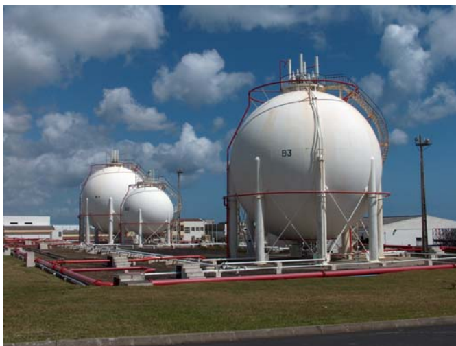
Figura 1.3. Parque de armazenagem com reservatórios esféricos (Parque de GPL da Nordela, em Ponta Delgada Ilha de S. Miguel. Propriedade da SAAGA - Sociedade Açoreana de Armazenagem de Gás, S. A.).
