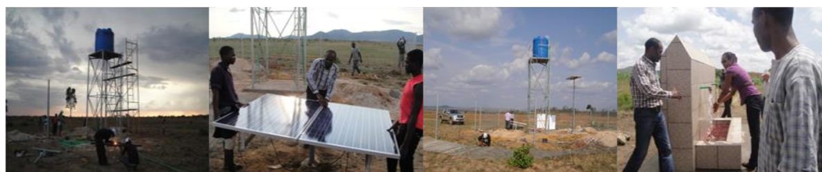
Figura 11 - Sistemas de abastecimento de água por bombagem com energia solar.
