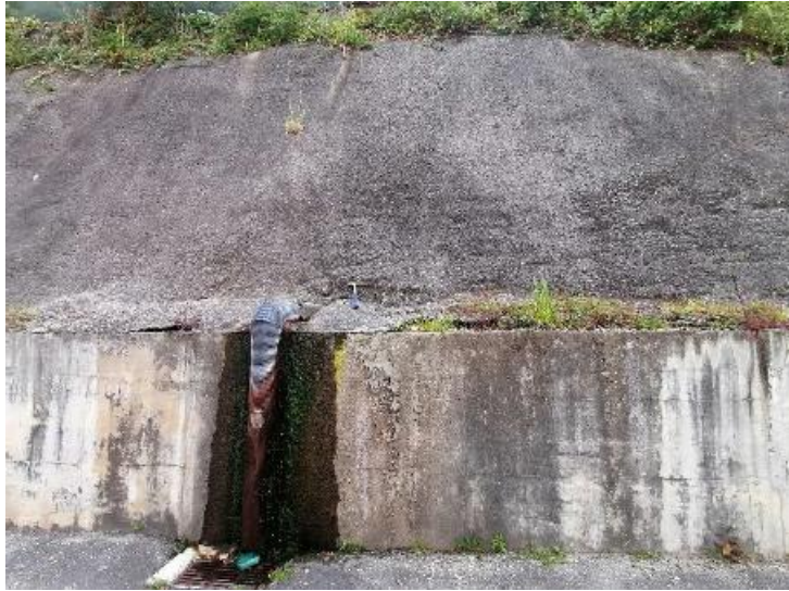
Figura 6.15 Estrutura de drenagem de água no muro de betão projetado.
