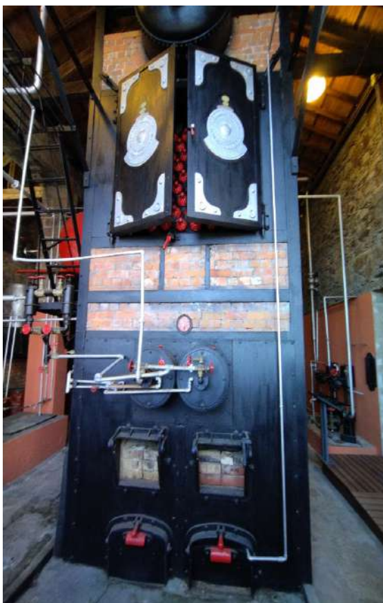
Figura 43: Museu das Flores, Núcleo da Fábrica da Baleia do Boqueirão, Energia – caldeiras. Fotografia de Susana Soares, 2021.
