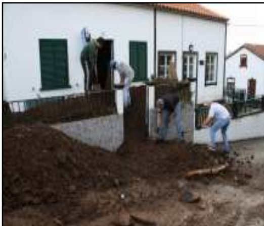
Foto 3.12 – Habitação afetada por movimentos de vertente, na Rua do Saco (SRAM, 2009).
