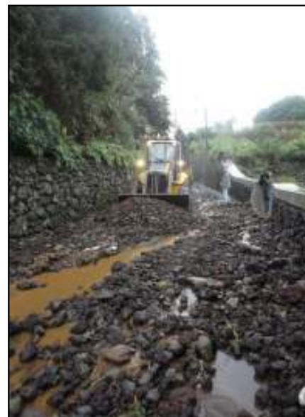
Foto 3.18 – Queda de paredes na Rua do Saco (JFA, 2011).
