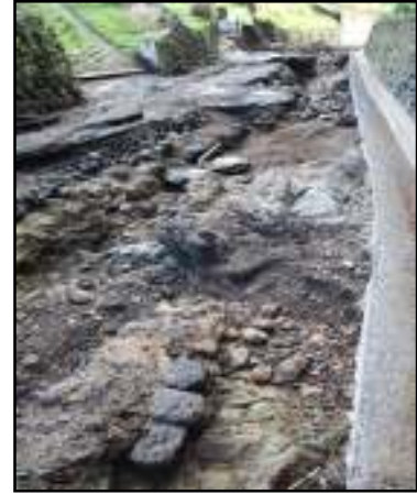
Foto 3.11 – Afluente da Ribeira da Aqualva destrói Rua do Saco (SRAM, 2009).
