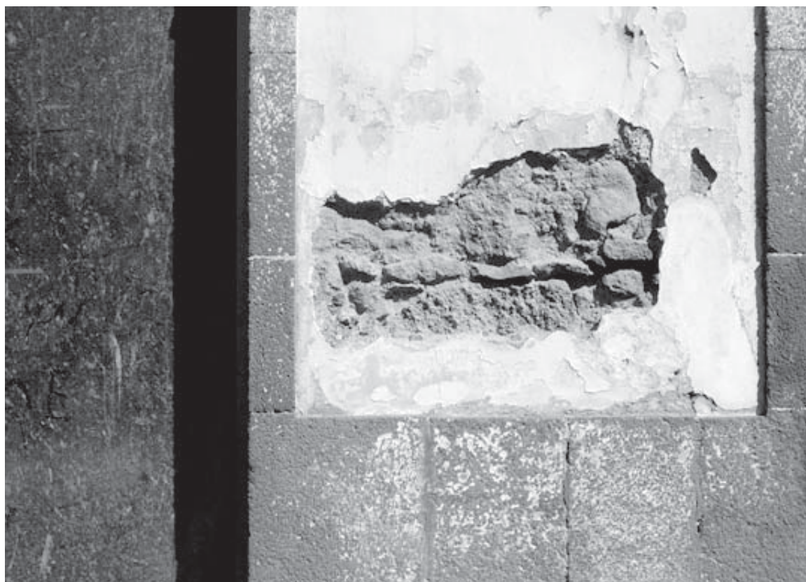
Aspecto do reboco tradicional degradado
