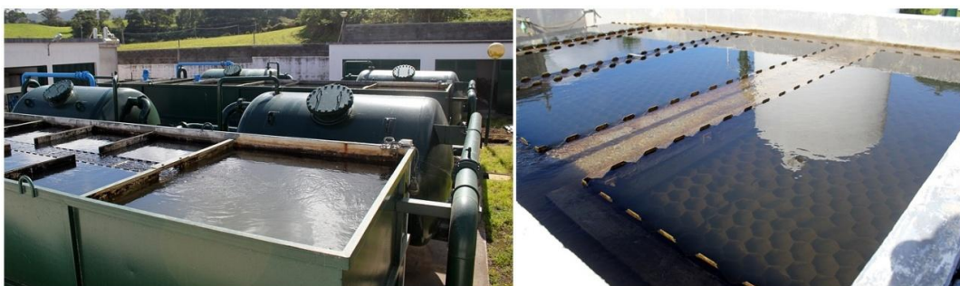
Figura 5.9. Tanque de receção de água bruta das Unidades Compactas de Decantação (fotografia captada a 25 de setembro de 2014).
