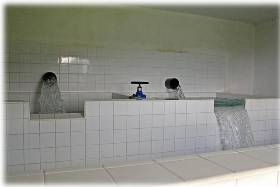
Figura 5.5. Caixa de junção de caudais das nascentes Chá Canto e Bandeirinha (fotografia captada a 25 de setembro de 2014).
