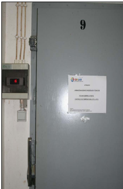
Figura 5 – Câmara refrigerada de armazenagem temporária.
