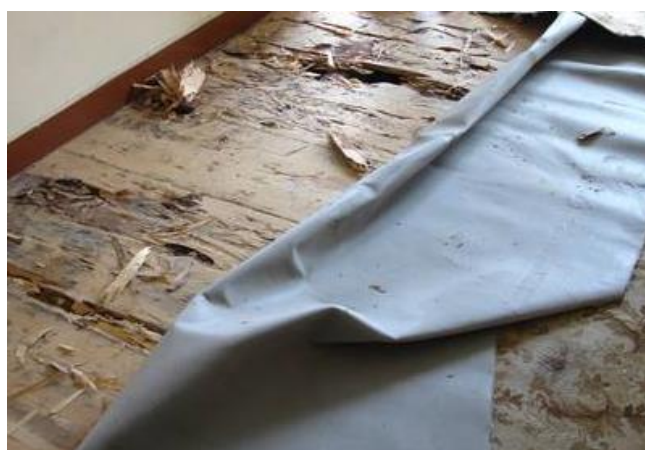
Figura 3: Exemplo de uma infestação destrutiva em que é necessária a substituição total das madeiras.
