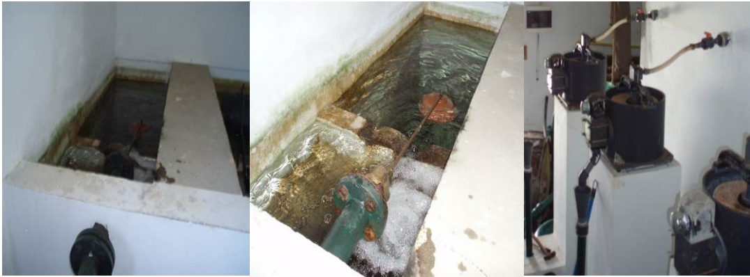
Figura 50 - Furo de São Mateus. Estruturas de decantação e de filtração de água. Foto.: José Machado.
