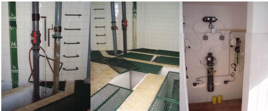
Figura 51- Estruturas de decantação, filtração, medição de caudais no Raminho. Foto.: José Machado.
