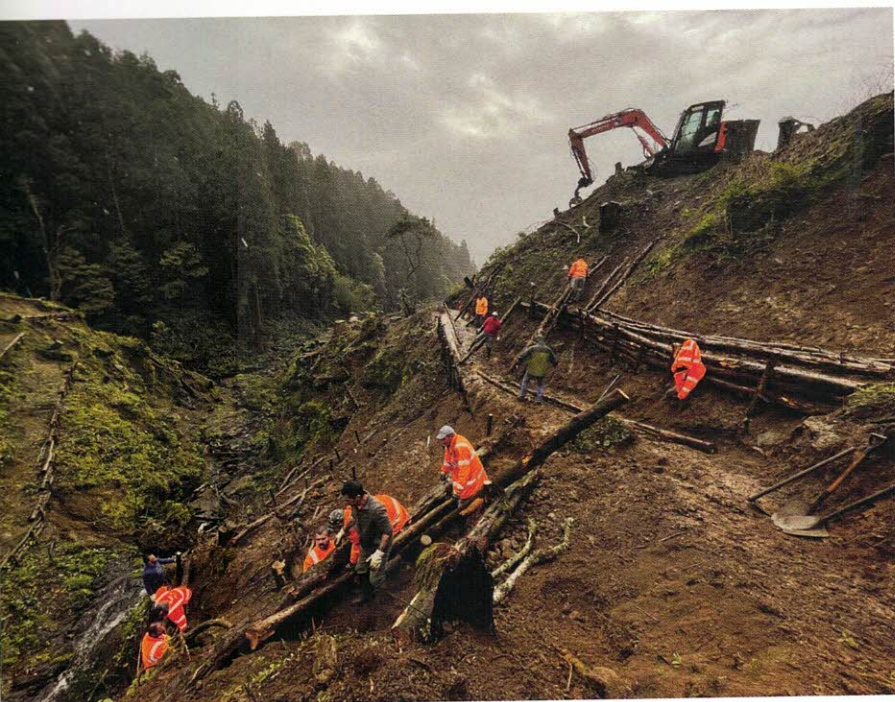
Trabalhadores da SPEA a construir estruturas de engenharia natural para consolidação das margens de uma linha de água na Mata dos Bispos, Povoação, após o controlo da vegetação invasora.
