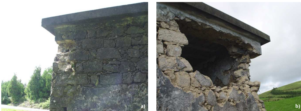
Figura 10.20 – Pormenor (a,b) dos danos observados nos edifícios localizados na zona epicentral, provocados durante a fase mais energética da crise sísmica da zona sismogénica do Fogo-Congro, em Setembro de 2005 (fotografias gentilmente cedidas por Paulo Amaral).
