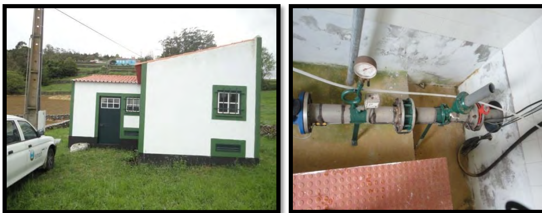
Figura 45 - Captação do Furo Farrouco (pouca qualidade de água) com tratamento hipoclorito de sódio – ZA1
