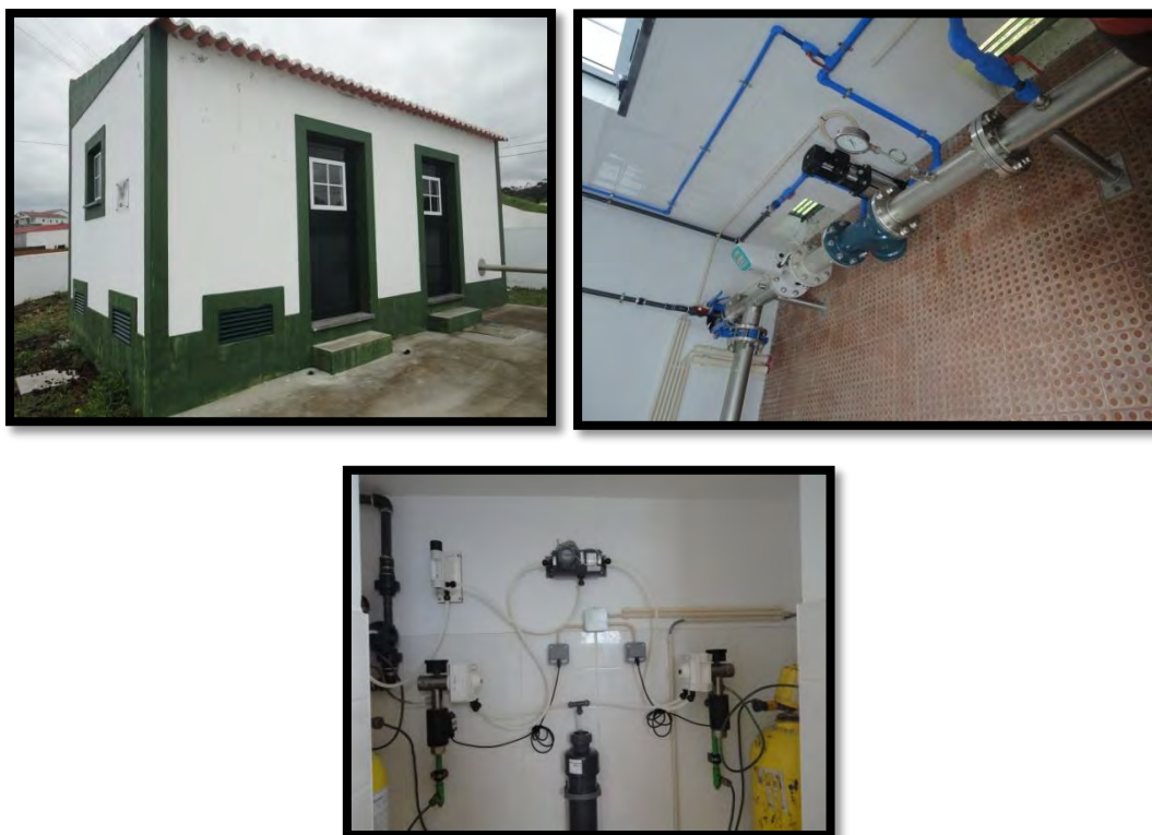
Figura 43 - Captação do Furo Capitão-mor com tratamento cloro gás ( \text{Cl}_2 ) – ZA1
