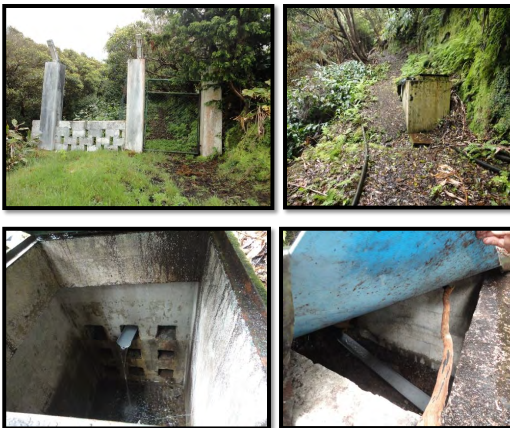
Figura 23 - Captação da nascente Fonte da Telha (vedação em mau estado, sem proteção)
