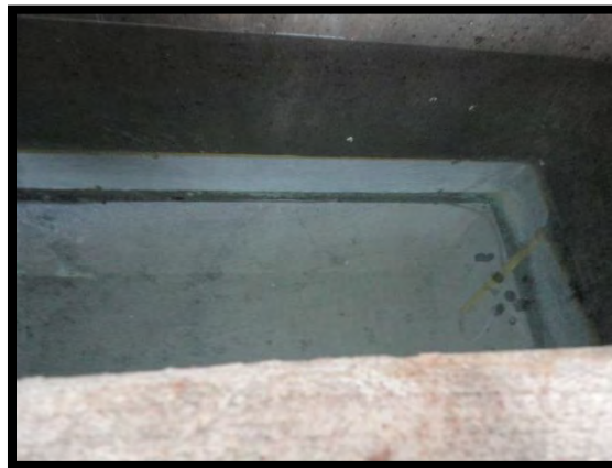
Figura 55 - Reservatório RR ou CPC (Raminho) com tratamento hipoclorito de sódio.
