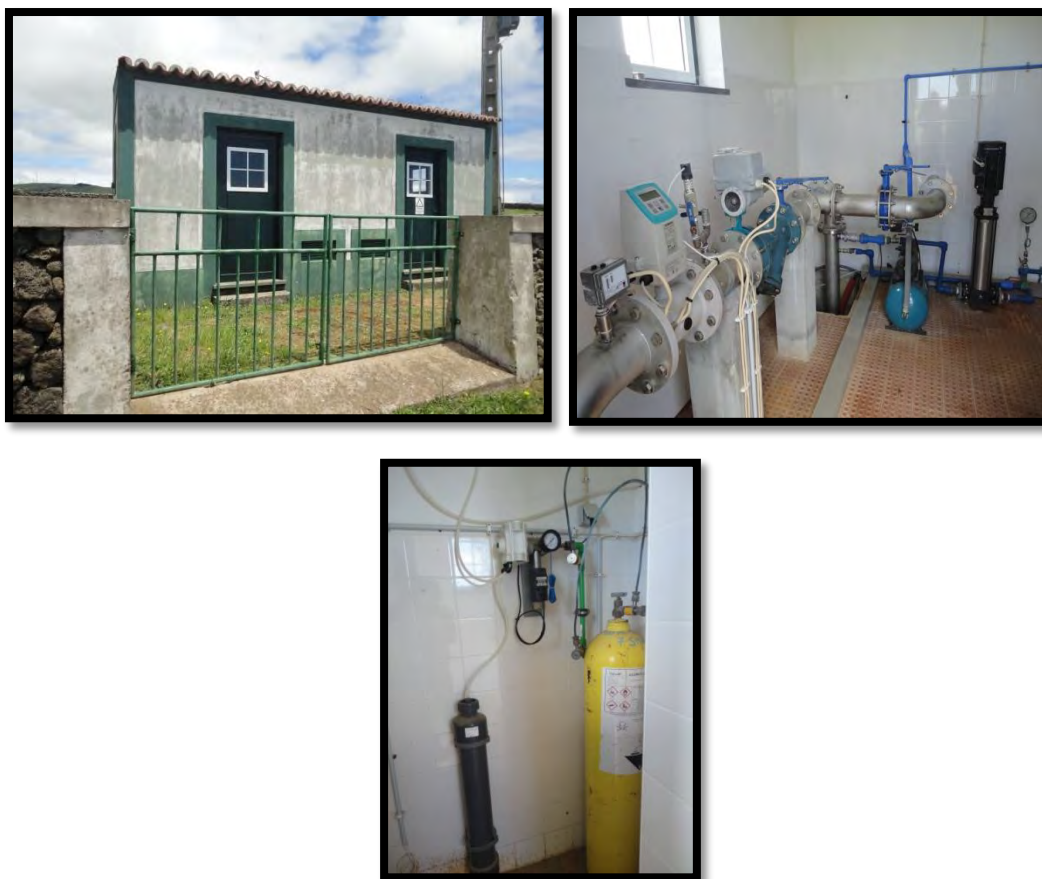
Figura 51 - Captação do Furo Santana com tratamento cloro gás – ZA1
