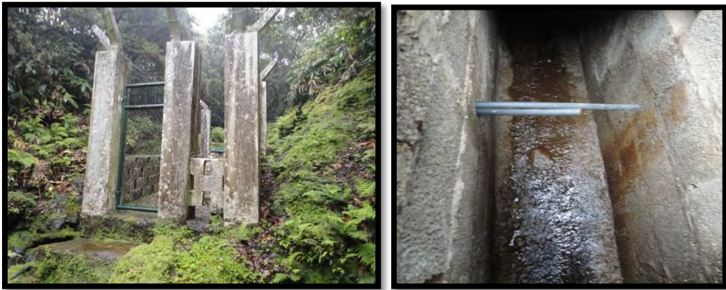
Figura 15 - Captação da nascente Areiros 1 (vedação em mau estado) - Raminho
