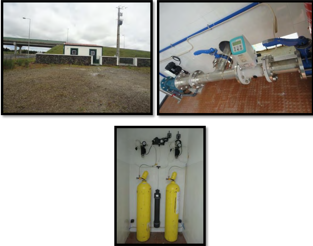
Figura 47 - Captação do Furo Achada com tratamento cloro gás – ZA1
