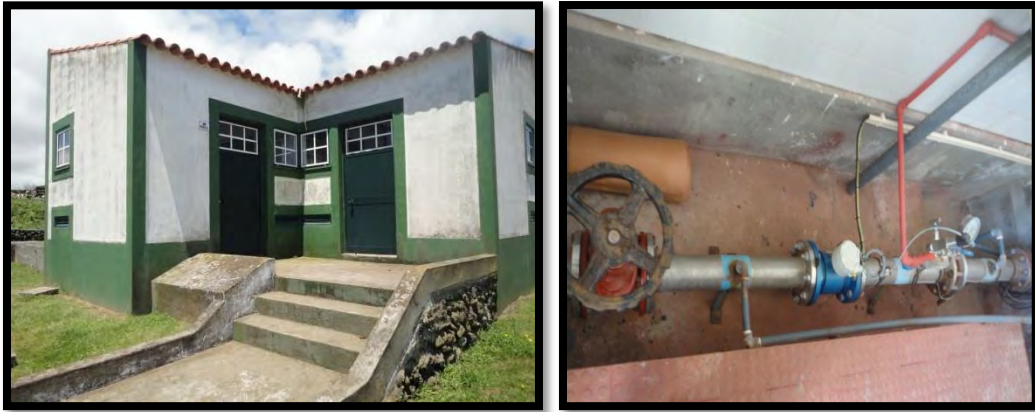
Figura 52 - Captação do Furo Caminho do Mato com tratamento cloro gás – ZA1
