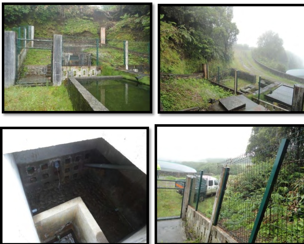
Figura 21 - Captação da nascente Fonte de Baixo (vedação em mau estado) – Serreta
