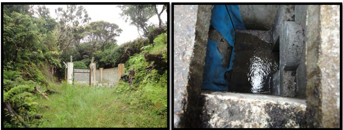
Figura 20- Captação da nascente João Branco (vedação em mau estado) – Serreta
