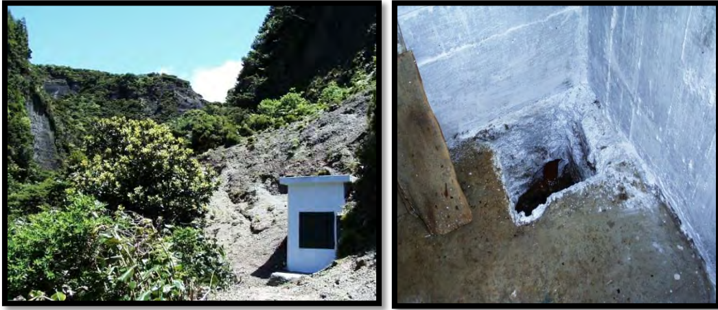
Figura 25 - Captação da nascente Negrão de Cima (sem vedação) – Serreta (Fonte: SMAH, 2013).
