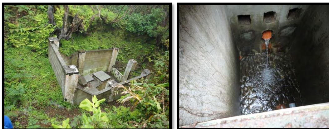
Figura 22 - Captação da nascente Fonte da Igreja (vedação em mau estado) – Serreta
