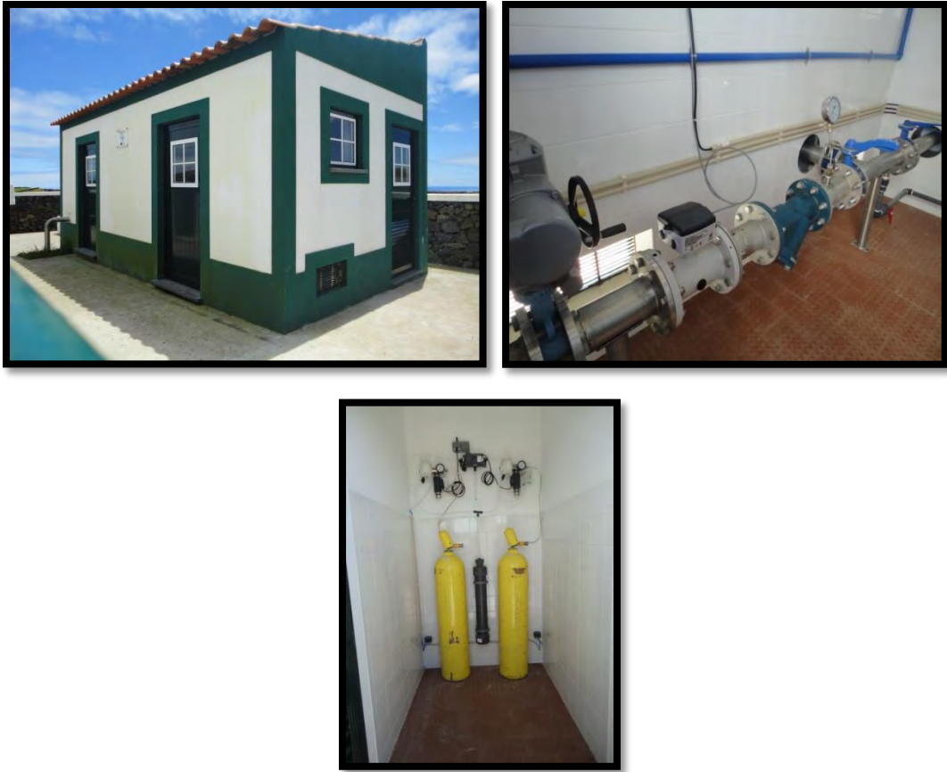
Figura 49 - Captação do Furo Santana Norte com tratamento cloro gás – ZA1
