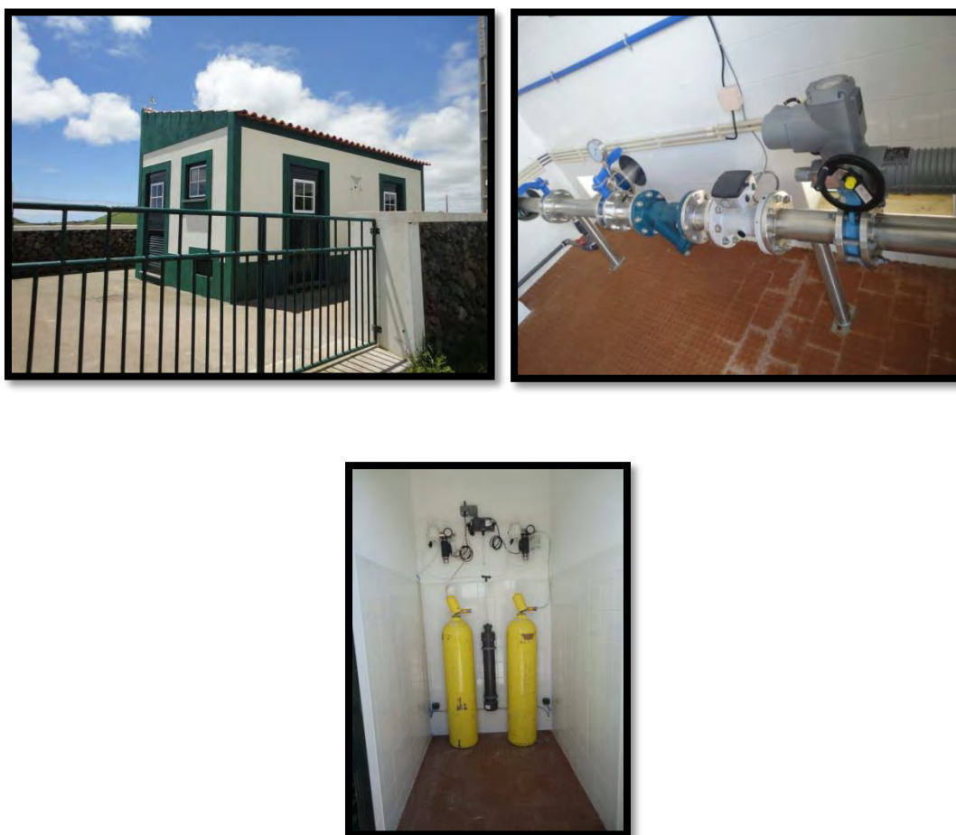
Figura 48 - Captação do Furo Trinchais com tratamento cloro gás – ZA1
