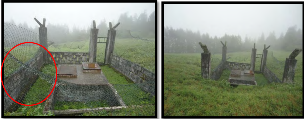
Figura 17 - Captação da nascente Areeiros 3 (vedação vandalizada) - Raminho
