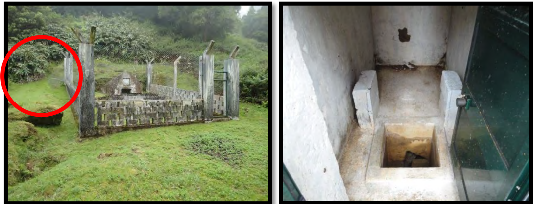
Figura 14 - Captação da nascente Cerro (vedação vandalizada) - Altares
