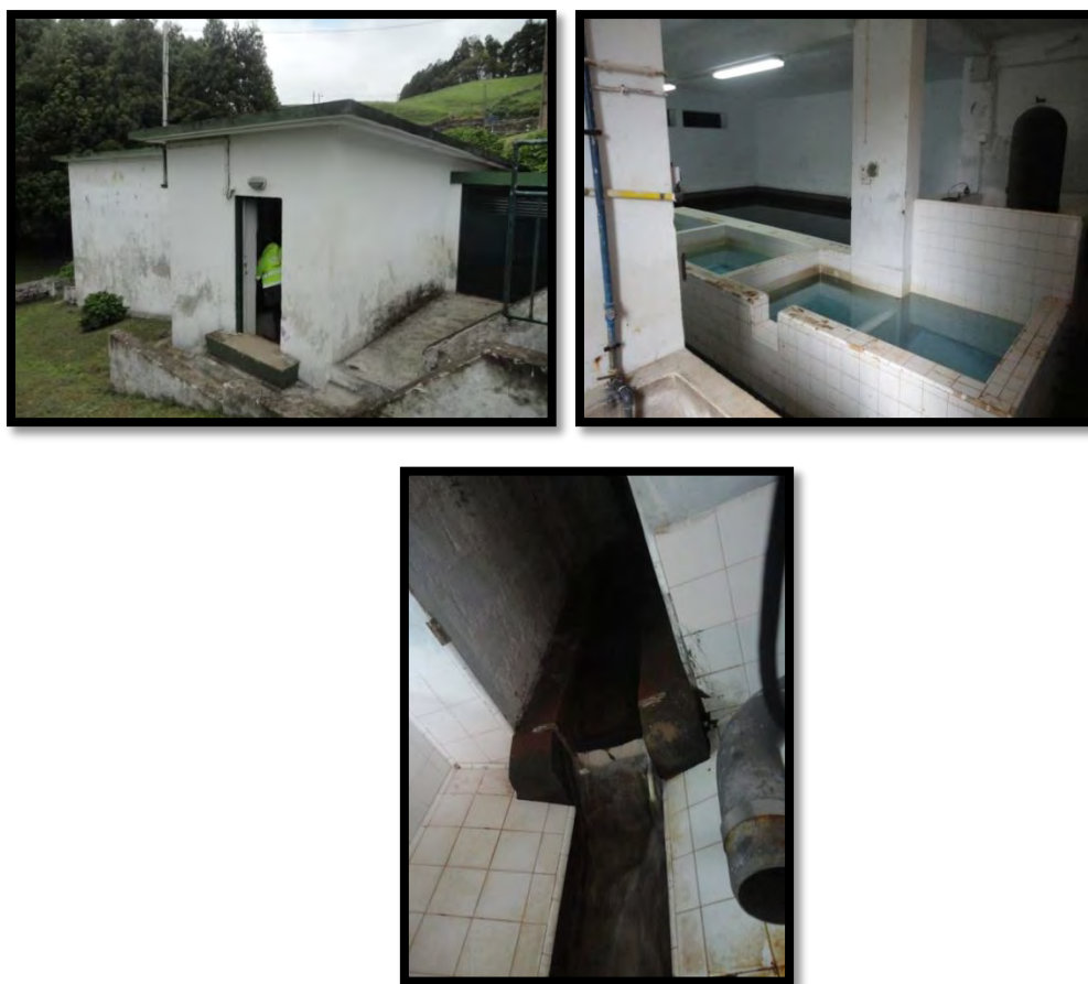
Figura 27 - Captação da nascente Principal da Fonte da Telha e ETA com tratamento hipoclorito de sódio
