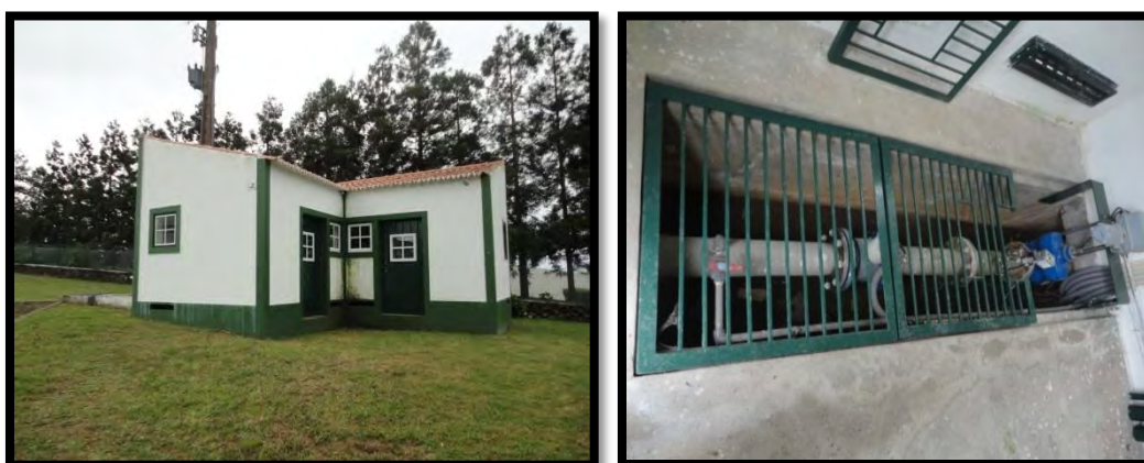
Figura 46 - Captação do Furo Vinha Brava com tratamento hipoclorito de sódio – ZA2
