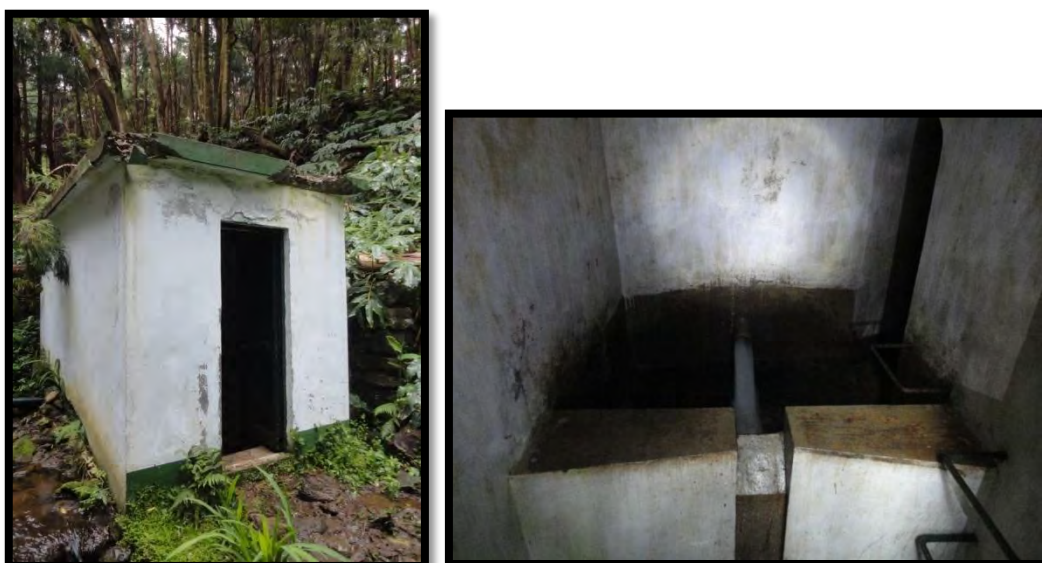
Figura 37 - Captação da nascente Nasce Água 3 – Nasce Água
