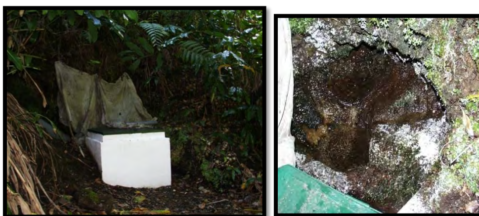
Figura 24 - Captação da nascente Negrão de Baixo (sem vedação) – Serreta (Fonte: SMAH, 2013).
