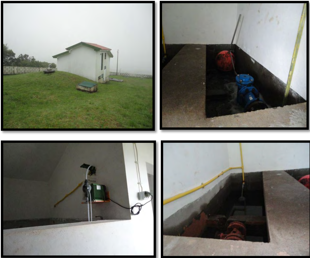
Figura 56 - Reservatório RN (Serreta) com tratamento hipoclorito de sódio
