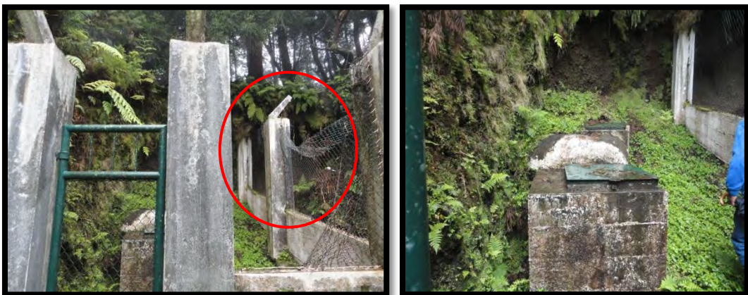
Figura 16 - Captação da nascente Areiros 2 (vedação vandalizada) - Raminho
