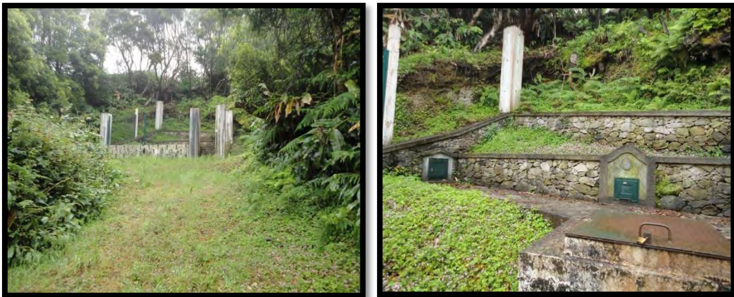
Figura 19 - Captação da nascente Fonte de Cima (vedação em mau estado) – Serreta
