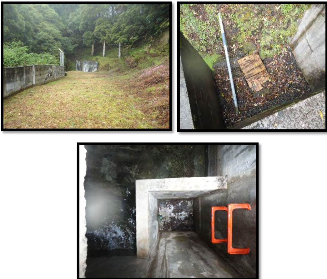
Figura 26 - Captação da nascente Cantaria – Serreta
