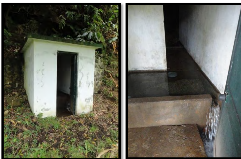
Figura 33 - Captação da nascente Gamelão 1 – Nasce Água
