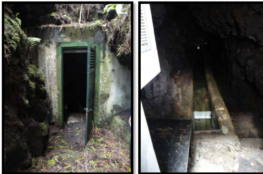
Figura 42 - Captação da nascente Furna d'Água – Cabrito
