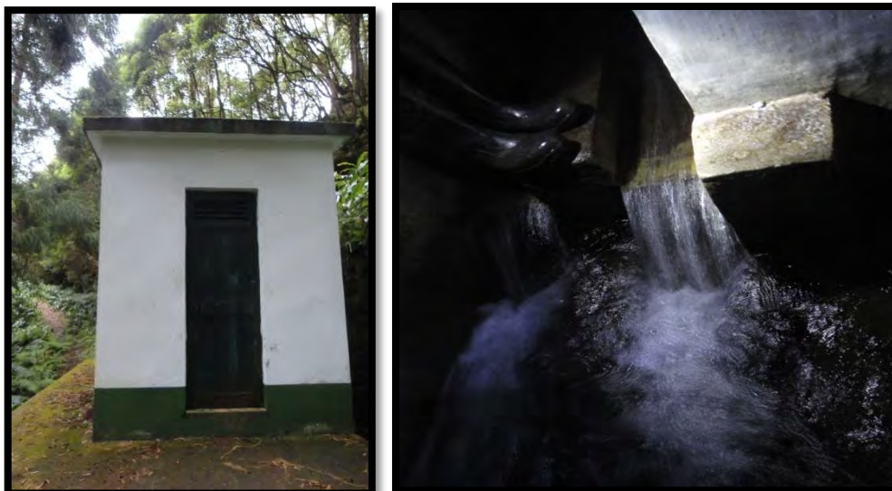
Figura 36 - Captação da nascente Nasce Água 2 – Nasce Água
