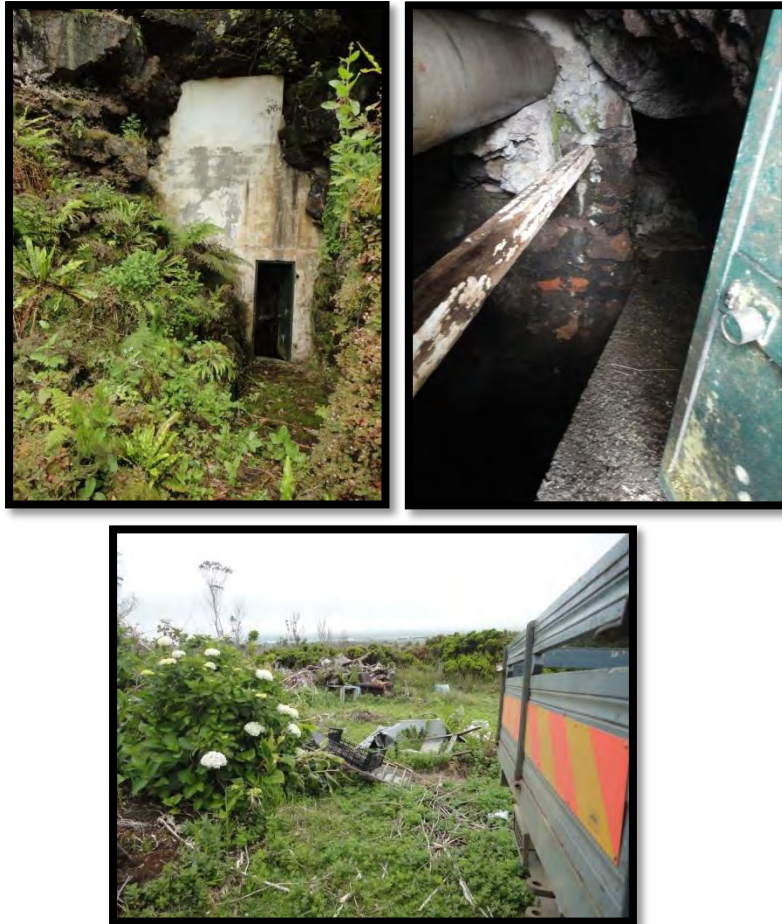
Figura 41 - Captação da nascente Pico da Cruz (poluição difusa) – Cabrito.
