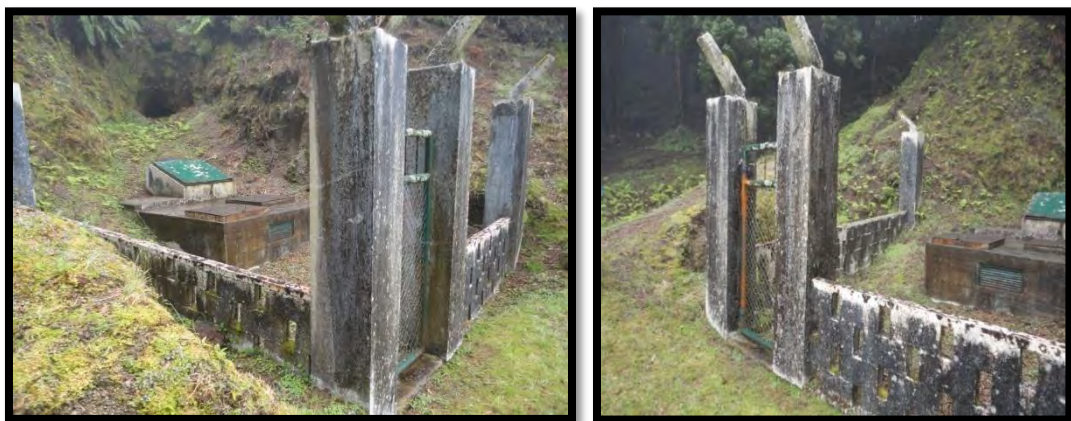
Figura 18 - Captação da nascente Borges 1 (vedação vandalizada num parque de merendas) - Raminho
