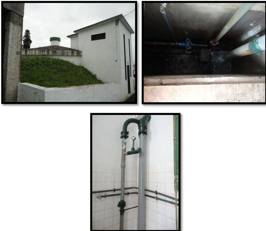
Figura 57 - Reservatório R1 (Can. Santo António) com tratamento hipoclorito de sódio
