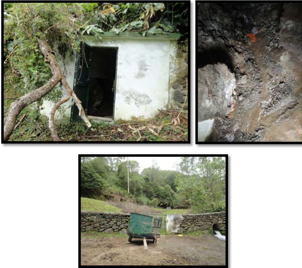
Figura 34 - Captação da nascente Gamelão 2 – Nasce Água
