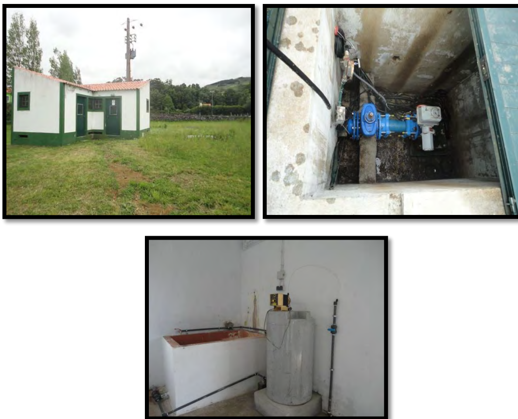
Figura 44 - Captação do Furo Terra Chã com tratamento hipoclorito de sódio – ZA1
