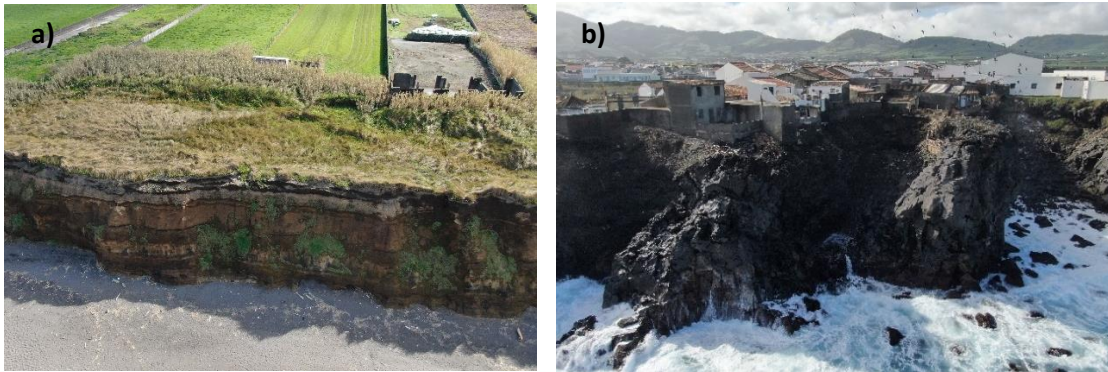
Figura 11 – (a) Vista da arriba da Praia de Santa Bárbara; e (b) vista da costa da zona do Bandejo, área com edificações em risco.
