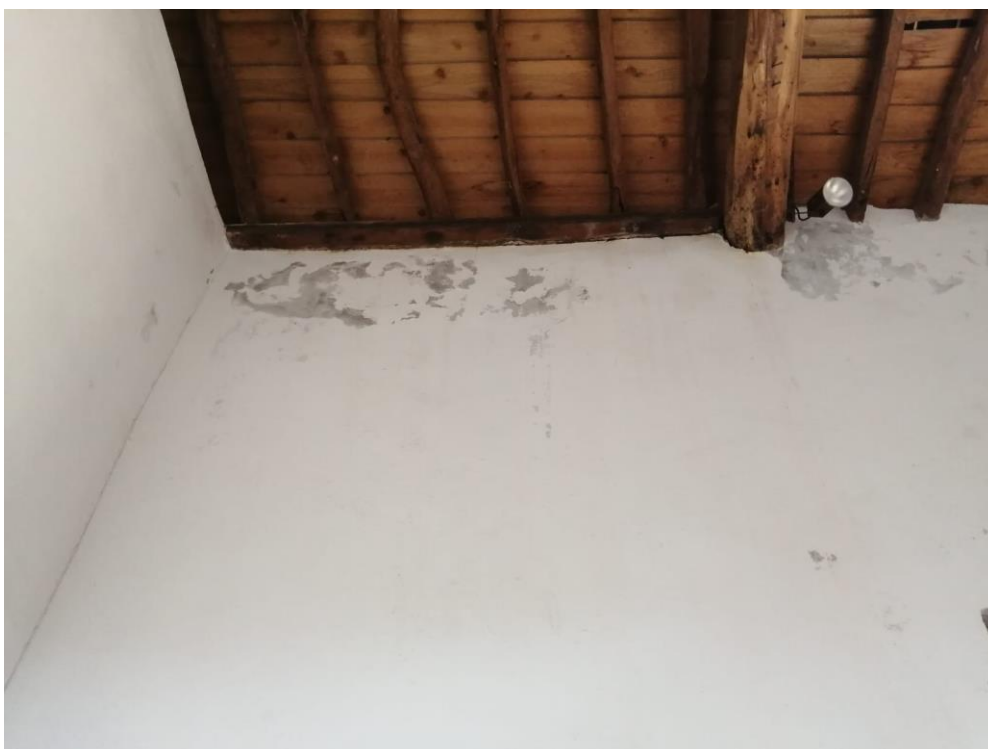
Figura 60 – Empolamentos e eflorescências verificados na sala que alberga a coleção adega e lagar. Museu Municipal da Ribeira Grande. Fonte: Rogério Medeiros, 2023.
