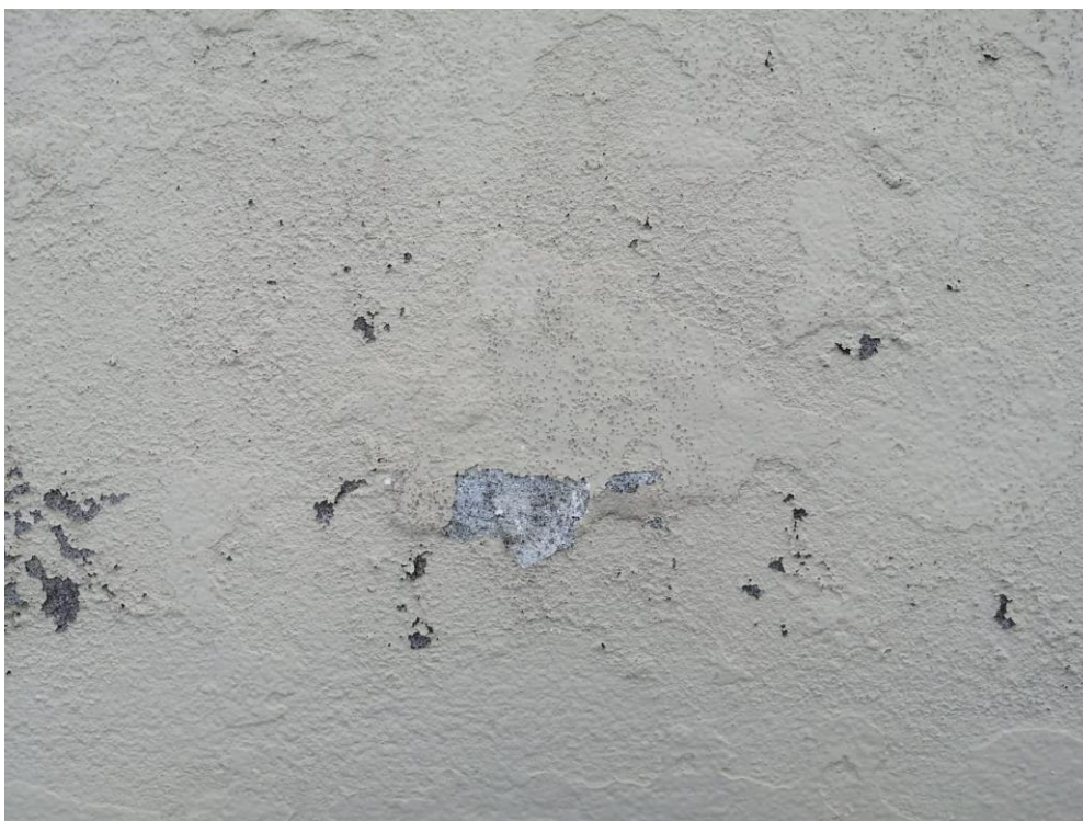
Figura 59 – Empolamentos e eflorescências verificados na fachada lateral do Solar de São Vicente Ferreira (ou Ferrer ), sede do Museu Municipal da Ribeira Grande. Fonte: Rogério Medeiros, 2023.
