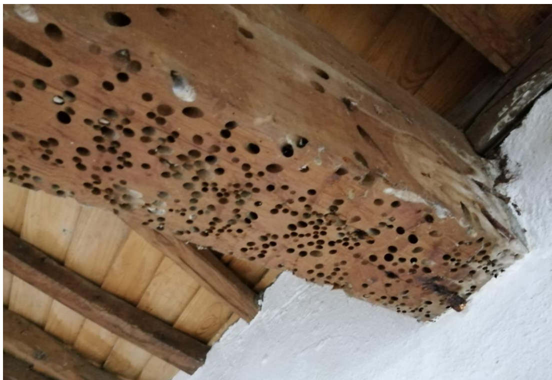
Figura 29 – Pormenor de uma trave danificada pela ação de insetos xilófagos. Museu Municipal da Ribeira Grande. Fonte: Rogério Medeiros, 2022.
