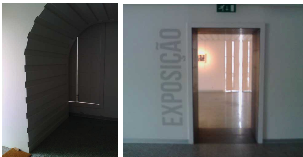
Gravura 8 – Janela da sala de exposições temporárias 2 semi obstruída pela parede. Nesta gravura também é visível a arredondamento da parede
