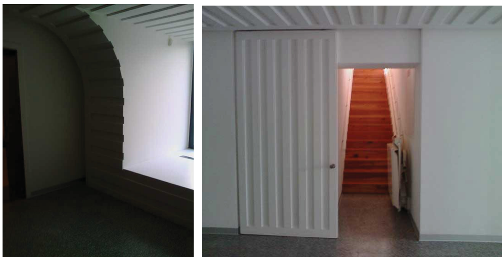
Gravura 6 – Parapeito largo da janela da sala 1. Nesta gravura também é visível a arredondamento da parede
