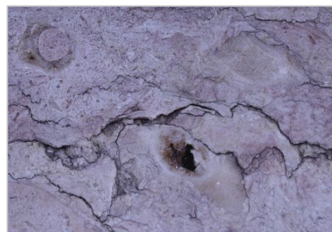
Figura 45- Pormenor de mancha de ferrugem na base do monumento a Roberto Ivens (Foto da autora).
