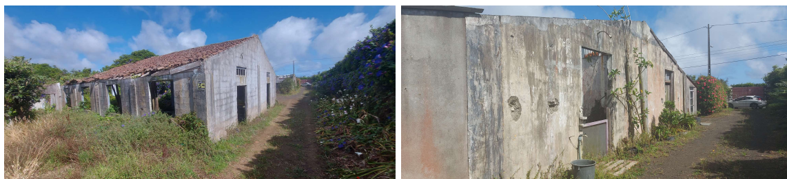
Figura 26 – Vista sobre os alçados frontal e lateral direito do pavilhão de tratamento (à esquerda) e do alçado lateral direito do pavilhão de hospitalização (à direita)
