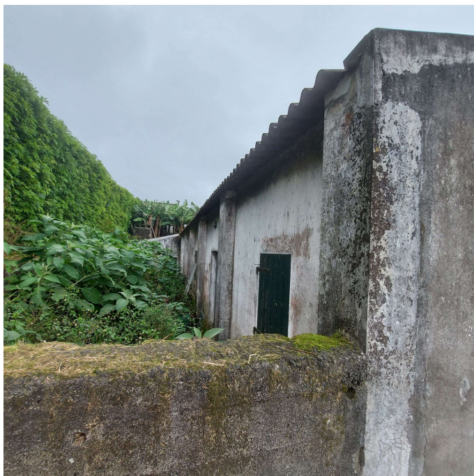
Figura A-6 - Alçado tardoz da enfermaria do HMC3, Vila Franca do Campo
