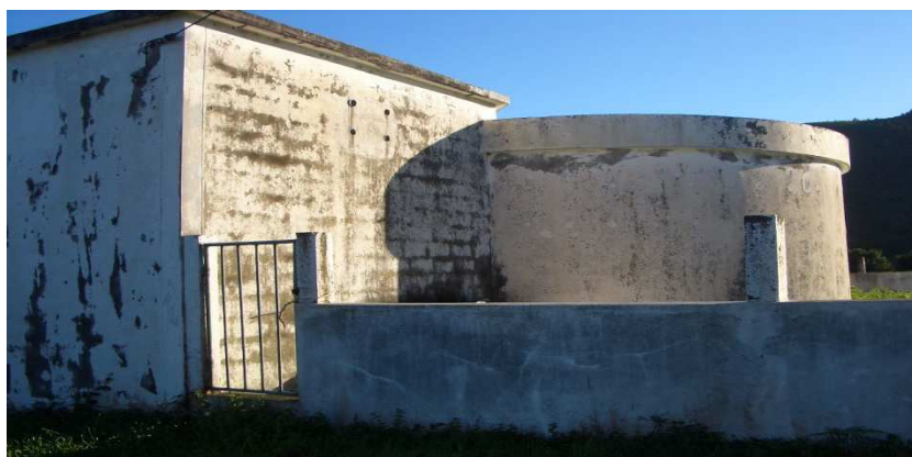
Figura 19: Estação de Tratamento de Águas (ETA).
