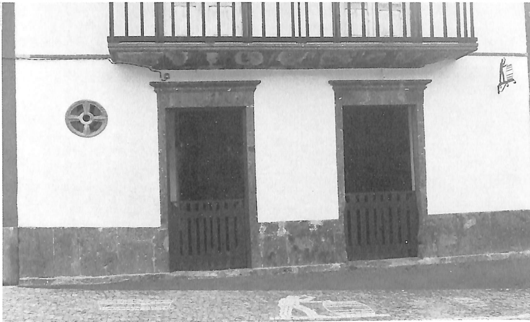
Foto 11 - Pormenor da fachada principal (rés-do-chão) do edifício onde se localiza a tanoaria. A cancela da porta esquerda foi substituída, respeitando-se o modelo existente, que se encontrava degradado, e a da porta direita foi construída de novo.
