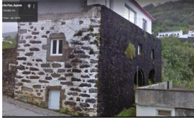
Figura 197. Moinho 1. Fachada virada à via pública. 2 Arcos de volta perfeita do cabouco. Maio de 2010.
